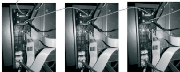
Подключение сигнального кабеля для трех ИБП, включенных в параллель
